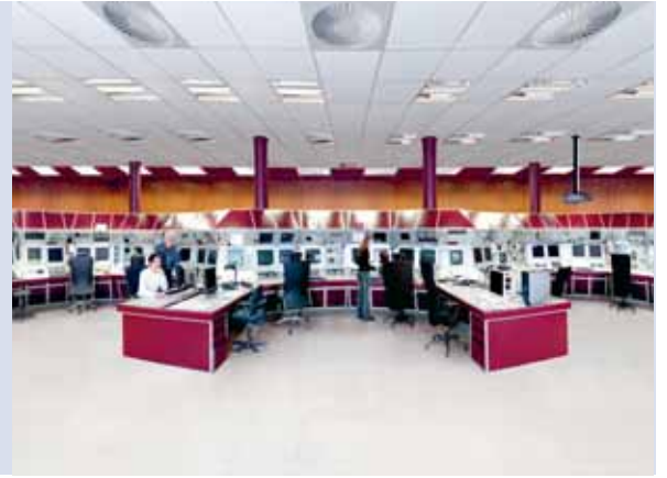
Hauptkontrollraum GSI Helmholtzzentrum für Schwerionenforschung GmbH, Darmstadt
